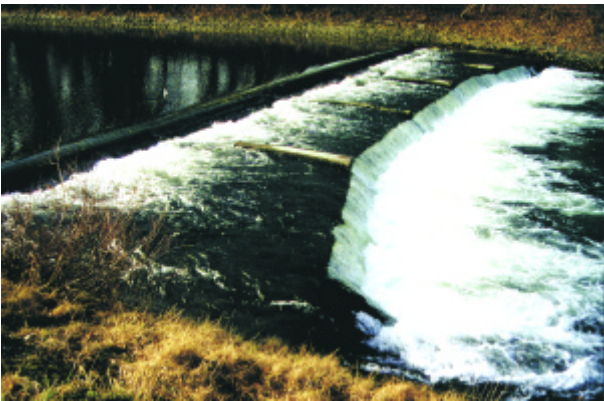
Die zahlreichen zur Stabilisierung der Sohle erbauten Schwellen behindern die biologische Durchgängigkeit
